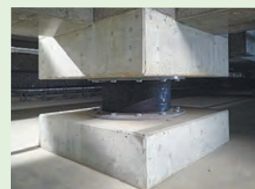
地下で新診療棟を支える免震構造
