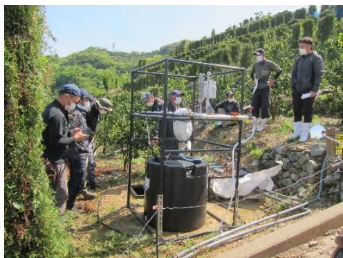
南予用水を利用したマルドリ施設(液肥混入器)
