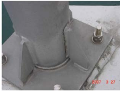
標識柱基部溶接部のき裂
