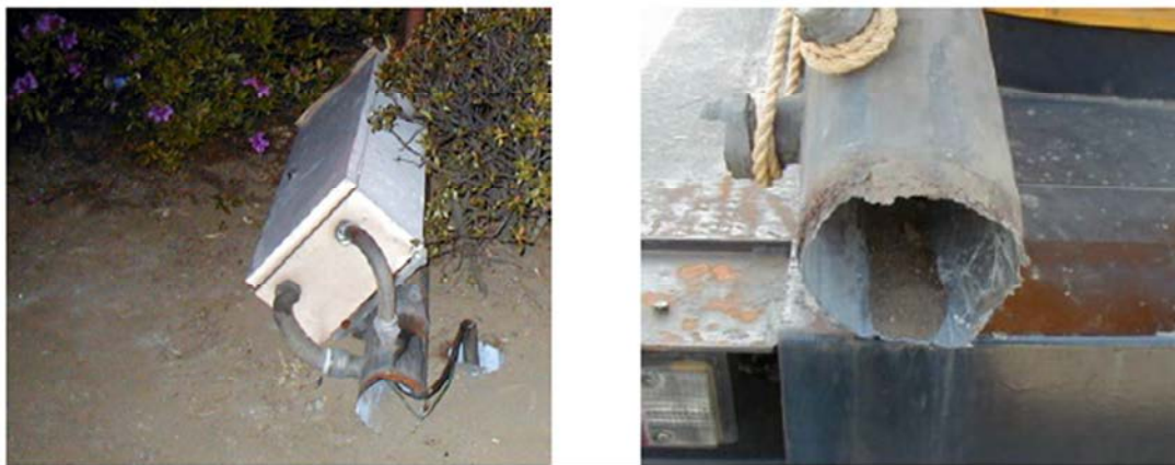
付写真6-1 路面境界部の腐食が要因となった倒壊事例
