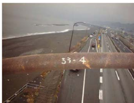
写真4-6 支柱本体の腐食事例
