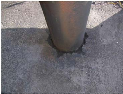
腐食、路面付近での滞水
