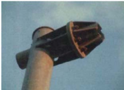
標識横梁基部の破断による標識板落下 (強風の多い海岸付近、2年経過)
