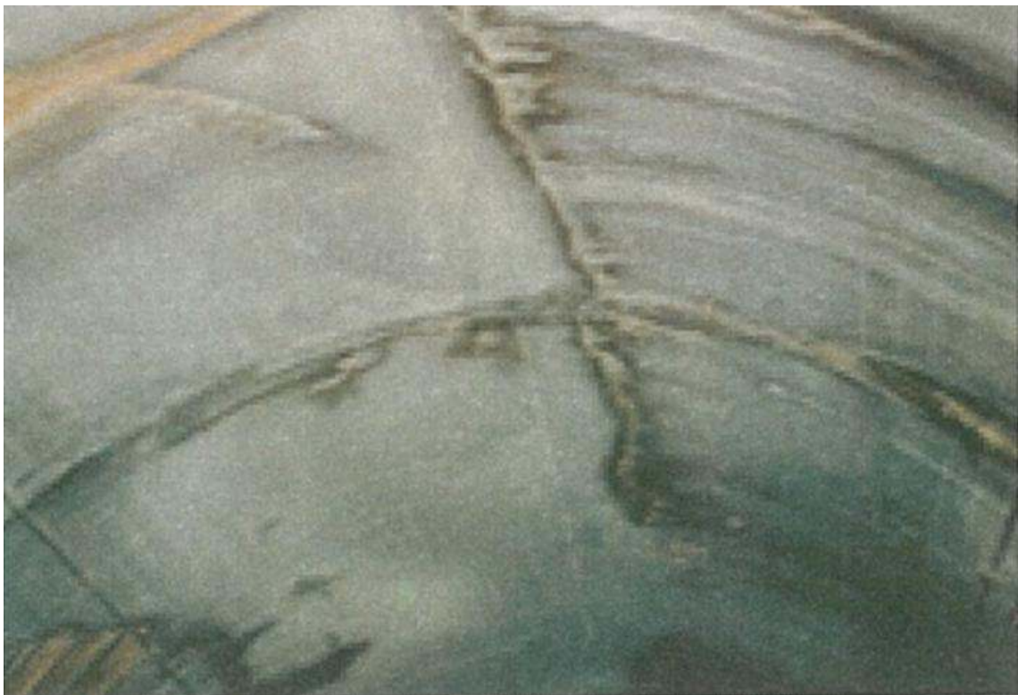
付写真-1. 2. 1 覆工の天端付近に発生した縦断方向のひび割れの例
