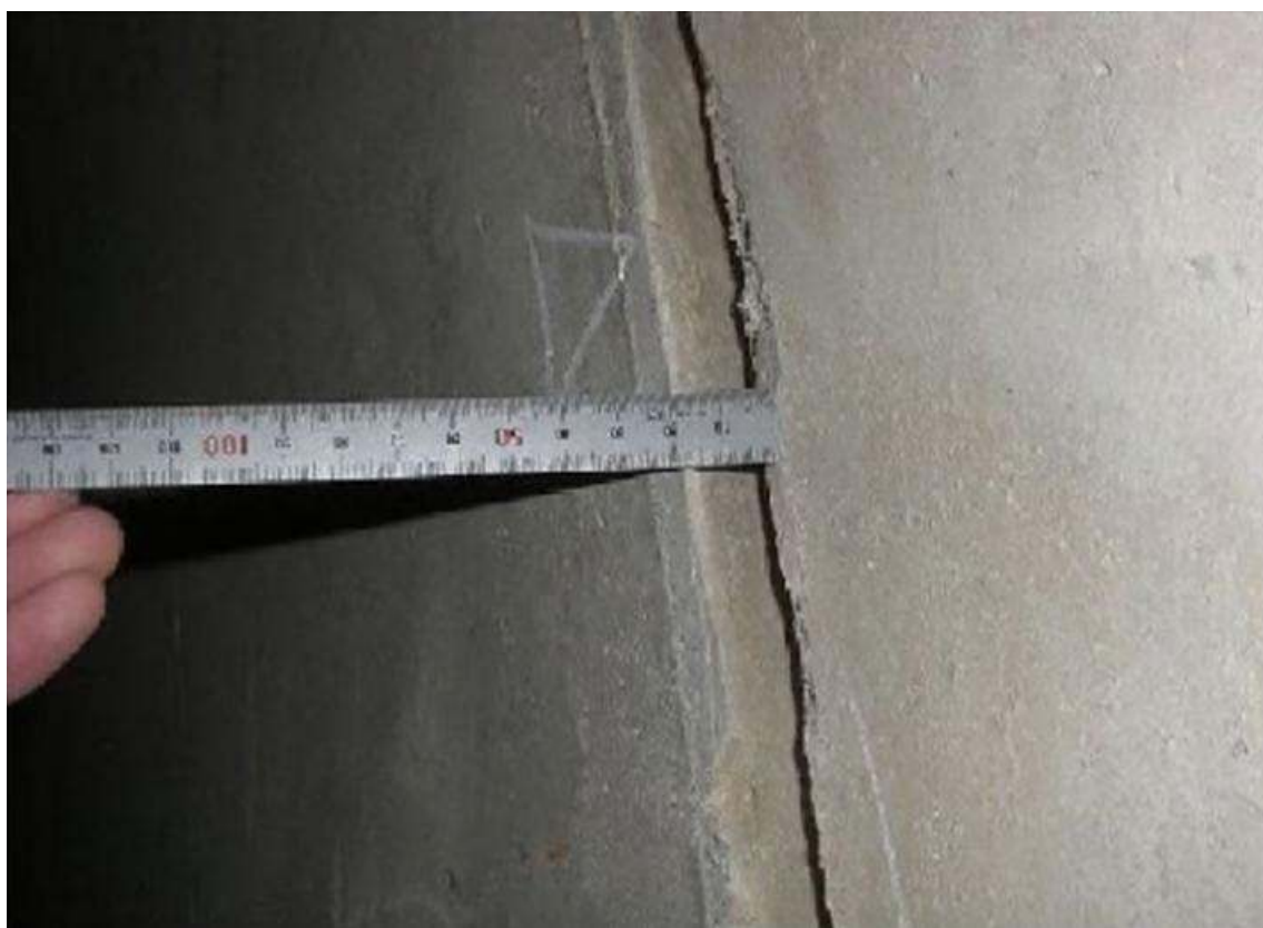
付写真-1. 4. 4 段差の例
