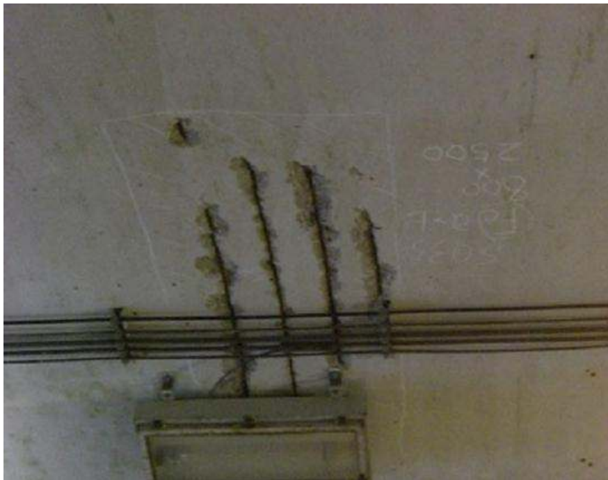
付写真-2. 1. 2 鋼材腐食の例
