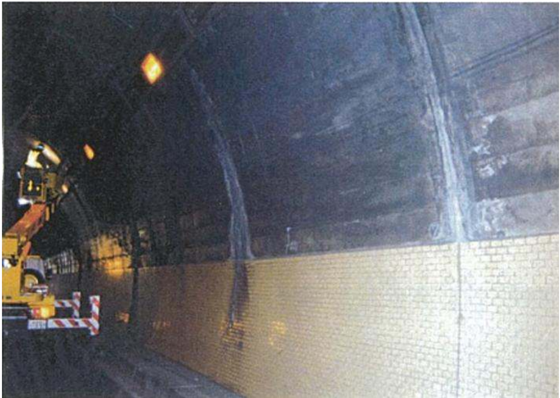
付写真-1. 3. 1 覆エスパンの中間付近に発生したひび割れの例
