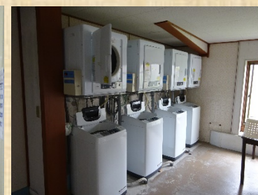
入替を行った洗濯設備
