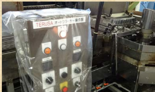
修繕・入替えされた設備
