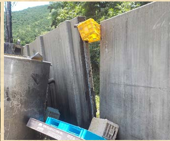
倒壊した防水壁
