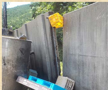
倒壊した防水壁
