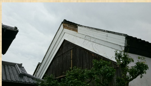
豪雨により被害を受けた屋根
