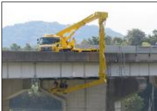
調査及び復旧に関する技術支援 (橋梁等構造物の異常調査)
