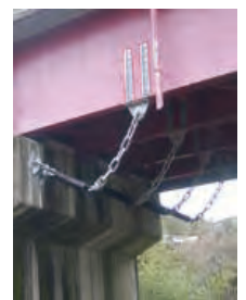
落橋防止装置 (緩衝チェーン)
