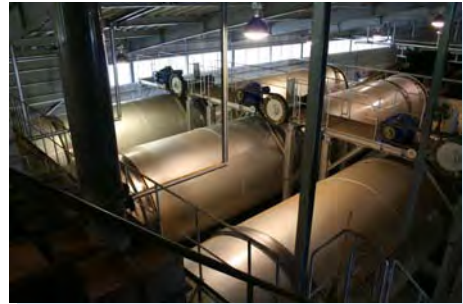
写真5 西予市野村エコセンター堆肥化設備
