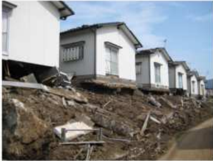
のり面の崩壊(益城町)
