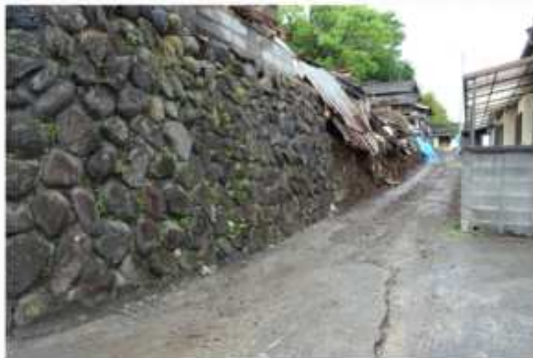
練積擁壁(大津町)
