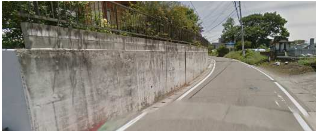
重力式擁壁の傾斜、宅地地盤のクラック
