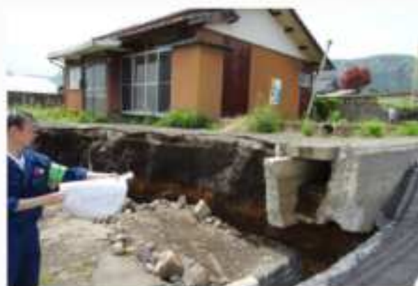
約1.3mの段差が発生
