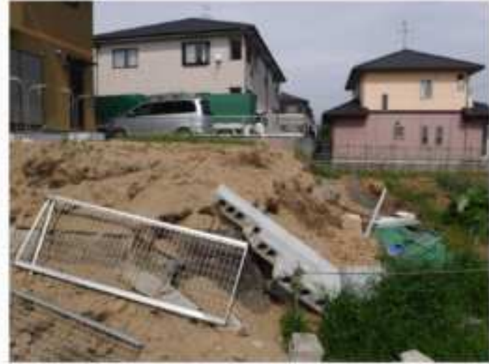
のり面の崩壊(益城町)
