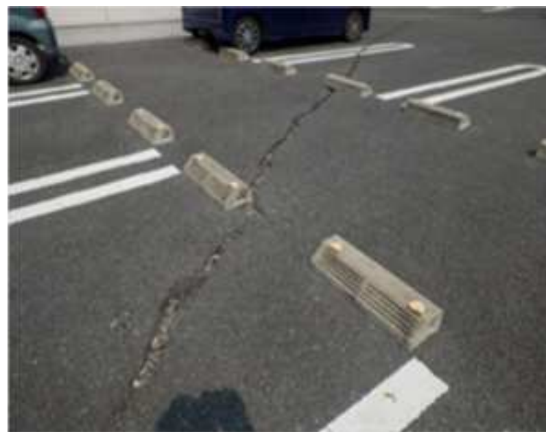
2018年7月 駐車場のひび割れはそのまま
