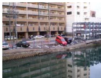
鋼矢板護岸の損壊状況
