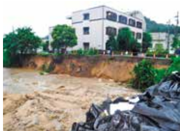
護岸被災状況(二)大川(松山市)
