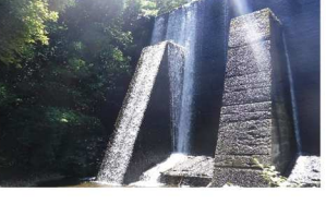
【第二貯水池堰堤】 水が堰堤を越流しています。
