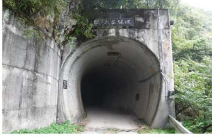
【梨ノ木谷隧道】 延長92m、幅3.5mのトンネルで、線形はS字状にカーブしています。
