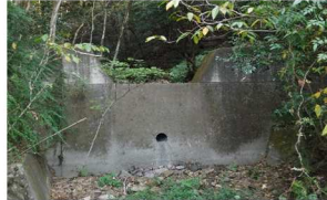
【治山谷止A】 平成13年に完成したコンクリート製の谷止工です。
