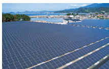
松山太陽光発電所 (四国電力㈱ホームページより)
