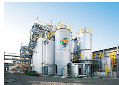
バイオエタノール製造実証プラント
