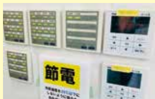
全客室空調の集中管理システム(省エネ)
