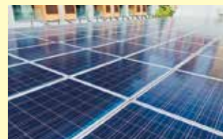
自社社屋屋上に太陽光発電パネル
