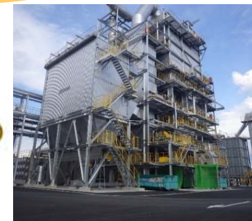
木質バイオマス発電 (松山市)
