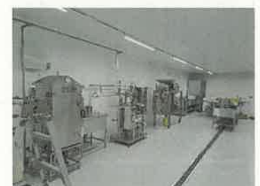
整備された加工設備
