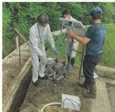
水田用水位センサーの設置
