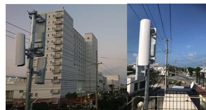
屋外でのWi-Fi通信
