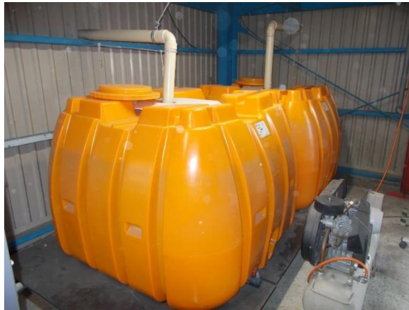
写真2. 2 m 3 雨水タンク×2個
