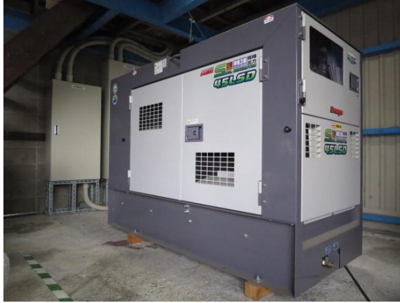
写真4. 緊急用発電機
