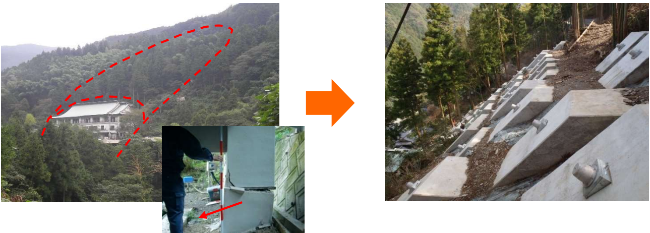
峰地区（西条市大保木、H23.9月発生；台風15号）
