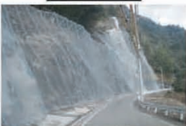
落石防止工(ロックネット工)
