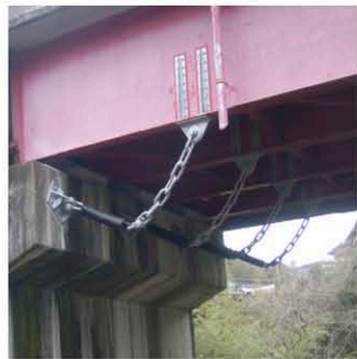
落橋防止装置(緩衝チェーン)
