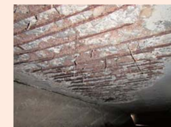
例:老朽化の進行した床板下面
