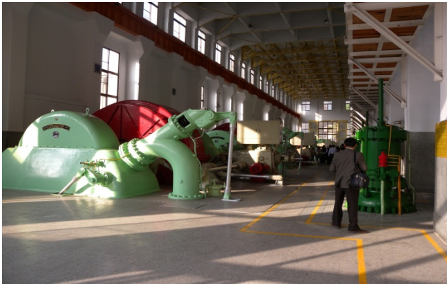
写真8：大観発電所（旧 日月潭第一発電所）内部の状況（建設当時とほとんど同じ機械で運転）
