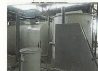
汚水浄化処理装置の導入
