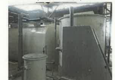
汚水浄化処理装置の導入
